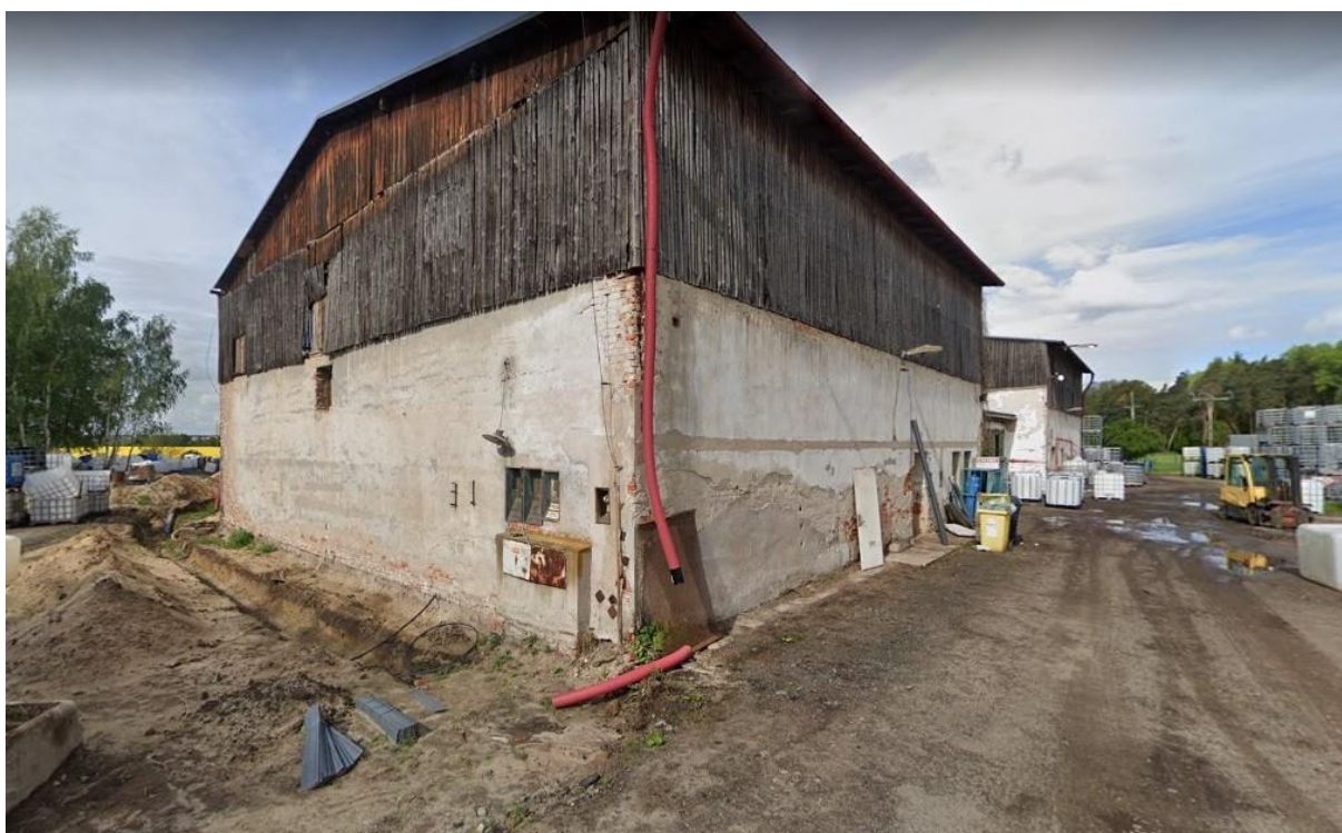
Obrázek 27: Stav bývalé budovy JZD, nespalitelnou část objektu tvoří zdivo z klasických plných cihel, střešní partie trpí pokročilým stadiem rozkladu dřevní konstrukce ( www.google.cz , 7. 3. 2020)
