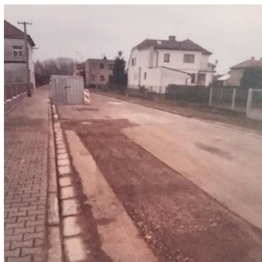
Obrázek 2: V ulici Dlouhá se propadla vozovka z důvodu havárie na kanalizaci, musela zasáhnout firma (foto Břežan č. 1 2020)
