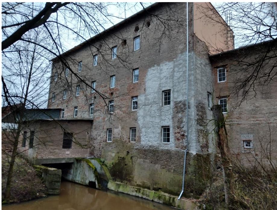
Obrázek 7: Stav budovy mlýna na počátku roku 2020, patrná je stabilizace zdiva na rohu objektu a nový svod (autor)
