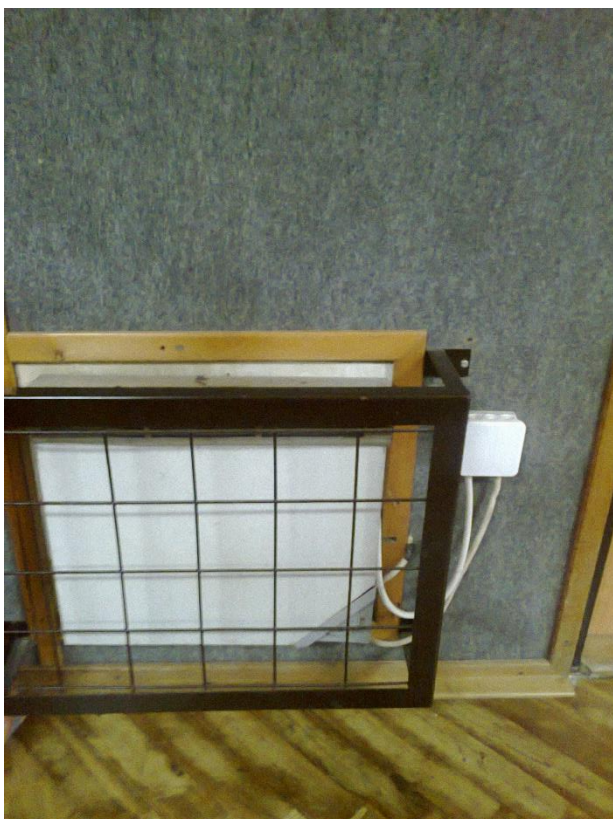
Obrázek 13: Radiátor ve cvičebně (foto autor, polovina října)
