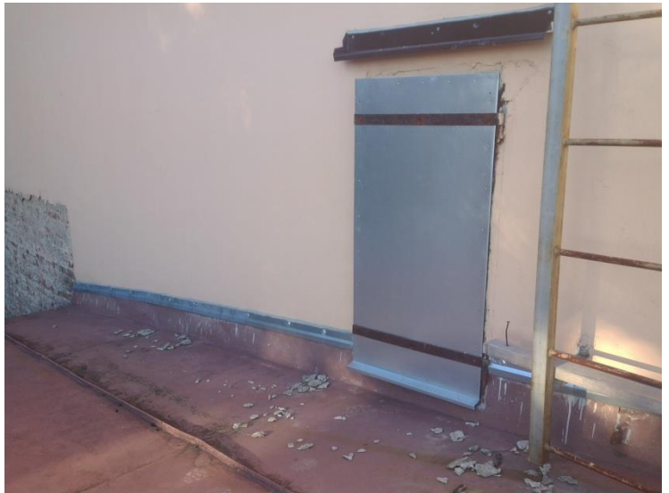
Obrázek 6: Fuka mezi starou střešní plechovou krytinou a zdívm zakrylo nové oplechování (foto autor, 31. 8. 2016)
