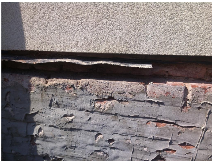
Obrázek 5: Část izolace na čelní (jižní) straně mlýna, cihelné zdivo je lehce překryto stavebním lepidlem (30. 7. 2015)
