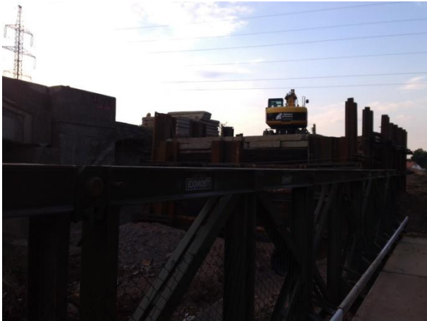
Obrázek 15: Snímek pořízen z provizorního mostu. Patrná je část výztuh a bednění nově budovaného mostu. Nelze přehlédnout ani stavební stroj
