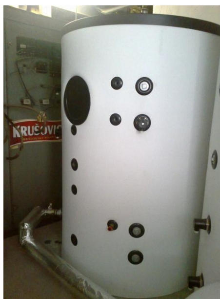
Obrázek 9: Součást vytápěcího systému, jedna z nádrží pro akumulovanou ohřátou vodu (15. 10. 2014)
