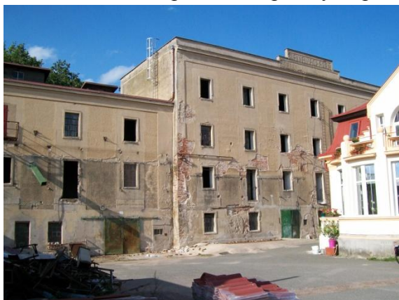
Obrázek 5: Hlavní budova mlýna po vyjmutí většiny oken - přední pohled (Stav k 25. 8. 2012)
